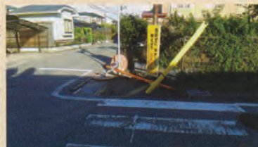
(支柱が腐食し倒壊したカーブミラー)
